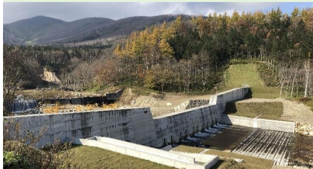
土石流から生命財産を守るため、砂防えん堤などの整備を行う
