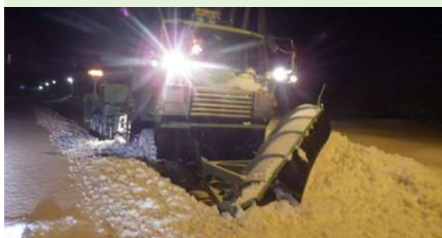
道路・河川等の巡視や点検・補修、道道の除排雪などの維持管理を行う。
